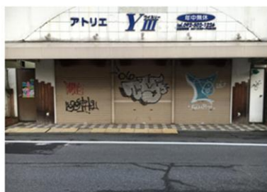
落書きで汚された美容室のシャッター
